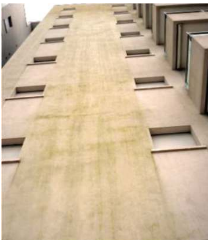
Rivestimento attaccato dalle alghe: elevata umidità e biocida non adatto alle specie tipiche della località
