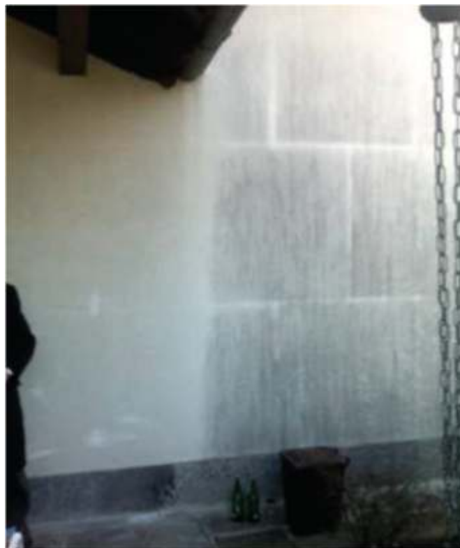
Sistema isolante attaccato dalle alghe: ben evidente la differenza tra la porzione umida e dilavata e quella protetta dalle intemperie. Il calore che passa attraverso i giunti non ben accostati dei pannelli blocca la crescita secondo linee nette
